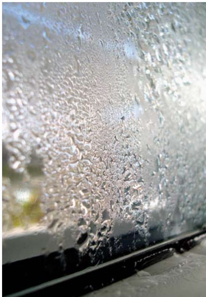
An Fenstergläsern sieht Kondenswasser unschön aus, kann die Rahmen beschädigen oder das Wachsen von Schimmelpilzen fördern.
